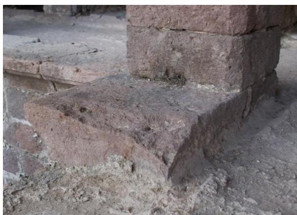
Εικ. Α9 Σωζόμενο κατά χώραν τμήμα του γείσου επίστεψης της στοάς του ισογείου
